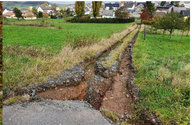
Zerstörter Wirtschaftsweg am Auslass des Dorfgrabens
